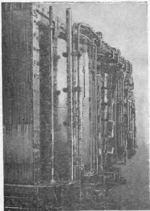
Рис. 6-37. Электродный трансформатор 40 000 кВ·А. Вид со стороны концевых отводов обмотки НН.
